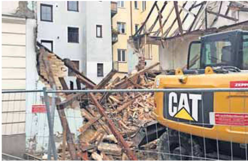
Kläglicher Anblick: Das denkmalgeschützte Haus ist weg, so viel steht fest. Jetzt wird darum gerungen, welche Konsequenzen das haben muss. FOTO: GRUNDNER/OH
