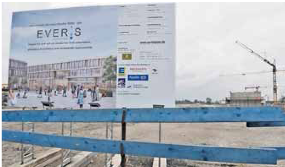
Nicht nur wegen Großbauprojekten wie hier am Oertelplatz am Allacher S-Bahnhof wird es enger, auch privat wird viel gebaut.
